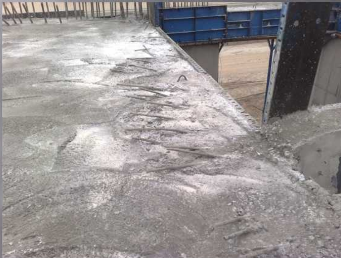
خم نامناسب آرماتورهای دیوار
